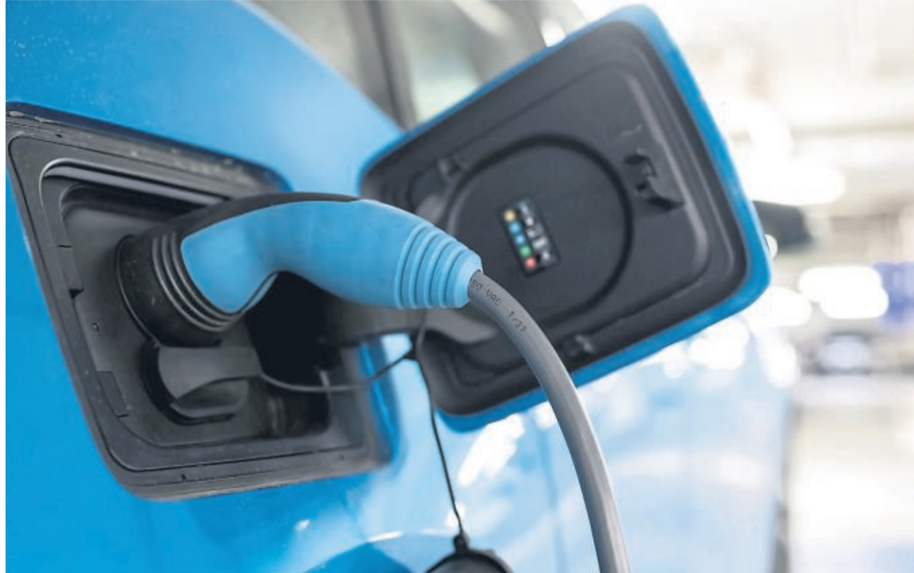
Keine Zustimmung des Vermieters oder der Miteigentümer mehr nötig: Mieter und Eigentümer haben ab Dezember einen Rechtsanspruch auf eine E-Ladesäule.
